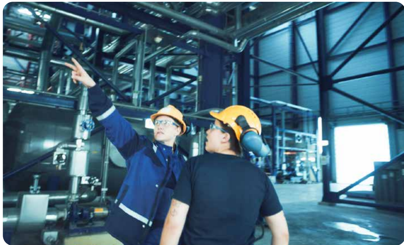
▲ Mitarbeiterinnen der Wärme Hamburg im Heizkraftwerk Tiefstack.
